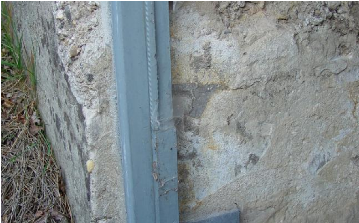
Vasthechting frame buitendeur bunker.jpg
