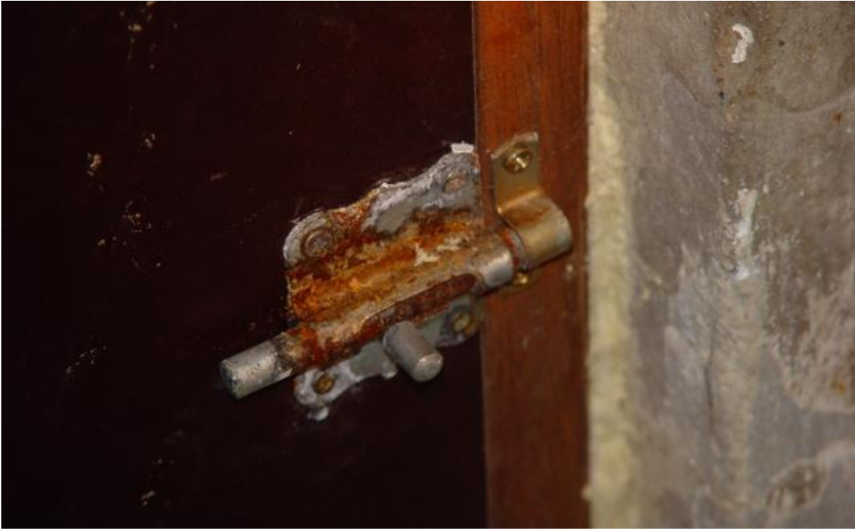
Schuifslot binnendeur bunker.jpg
