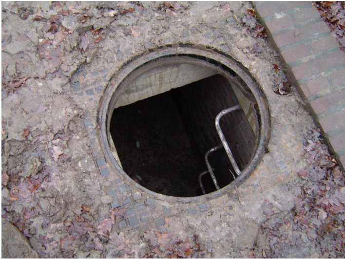
Figuur 7: Een putring met stijgbeugels als toegang tot de kelder.
